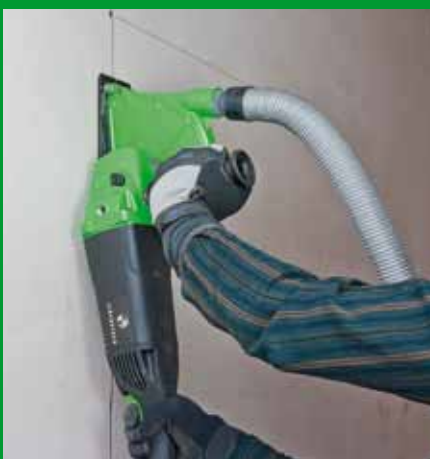
Durchbrüche in Mauerwerk
